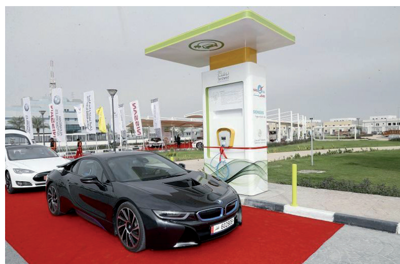
محطات شحن المركبات الكهربائية
